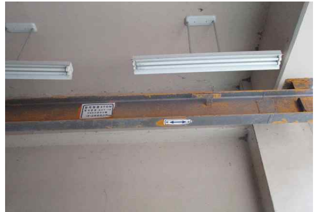
사진번호 14 위치 내부 천장 내 용 호이스트 레일 부식 (A=15.0m×0.2m)
