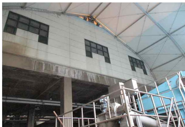
사진번호 17 위치 내부 지하층 보 내 용 백태 (A=15.0m×0.5m)
