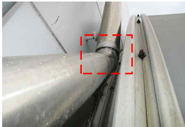
사진번호 15 위치 외부 벽체 내 용 배수관 이음부 누수 (1EA)
