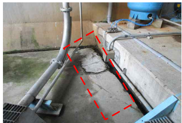
사진번호 18 위치 내부 지하층 바닥 내 용 콘크리트 박리 및 박락 (A=2.5m×0.5m)
