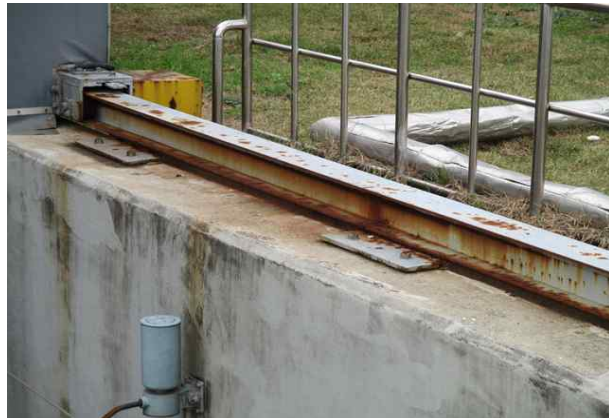
사진번호 13 위치 외부 바닥 내 용 H-Beam 부식 (A=5.0m×0.2m, 2EA)
